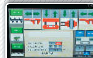
Инвертор PLC контроллер
